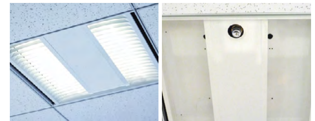
① 既存器具(蛍光灯)
