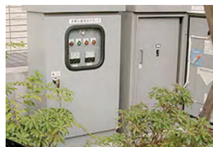
非常災害用井戸の操作盤
