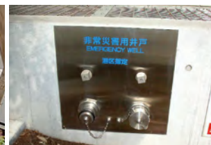
非常災害用井戸の排水口
